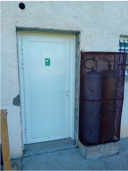
Porte du local chaufferie du stade présence du défibrillateur à l'intérieur
